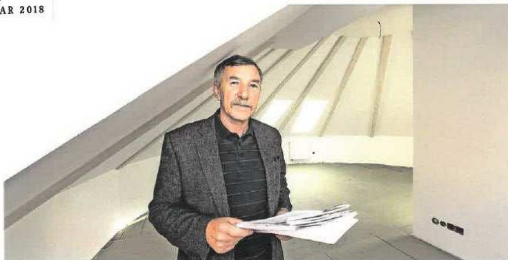
Jochen Walther und sein Team bauen das ehemalige Großharthauer Rittergut fürs Wohnen um. Hier steht er im Obergeschoss der Maisonnettewohnung im Rundbau. Die Balken des neuen Dachstuhls wurden sichtbar gelassen. Fotos: Steffen Unger
